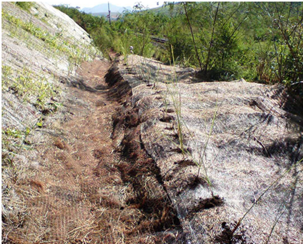
Figura 17.1.: Canaleta verde com vegetação herbácea estabelecida — canal de drenagem naturalizado que combina condução hidráulica com tratamento por infiltração.
