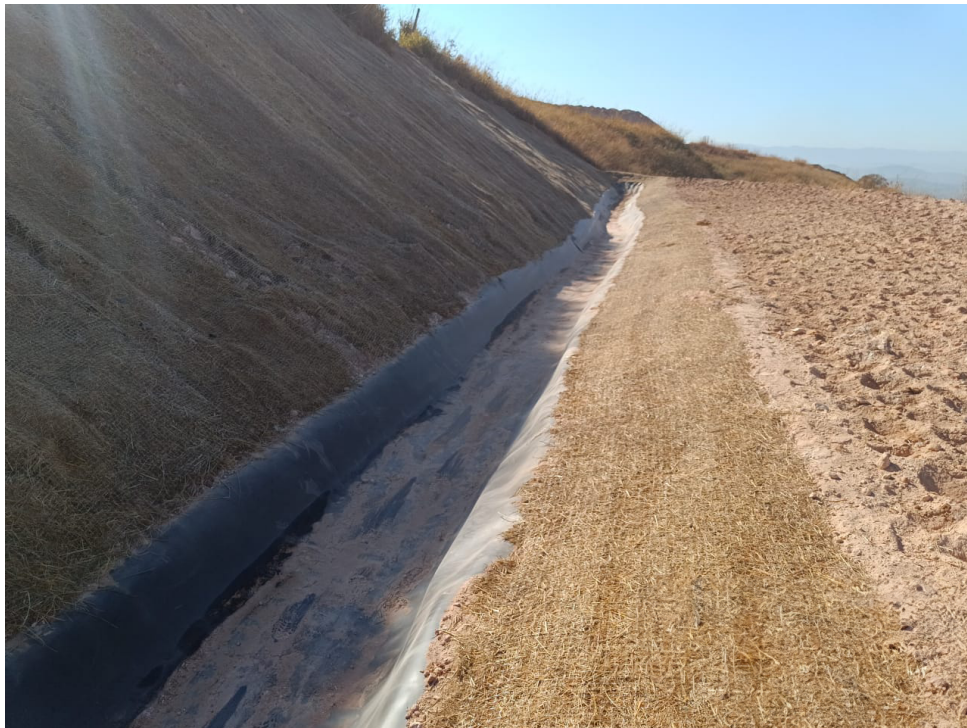
Figura 17.2.: Canaleta verde com hidrossemeadura — integração de drenagem naturalizada com revegetação por hidrossemeadura para estabelecimento rápido da cobertura vegetal.
